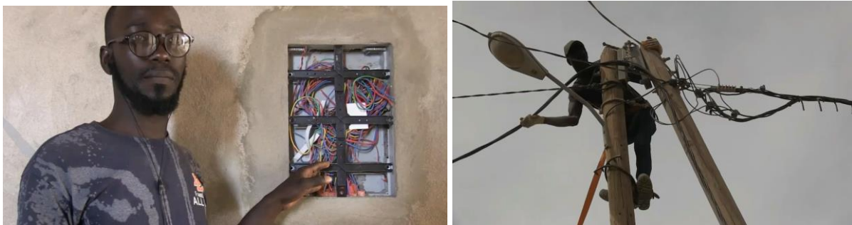
Foto links: Syabou Sylla aus Goumal (10 km von Waounde) erklärt einen Sicherungskasten. Foto rechts: Idrissa Djire aus Waounde verlegt in Gagny bei Dakar ein Leitungsnetz.
